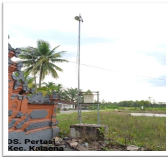
Sistem Peringatan Dini Banjir Sungai Kalaena
