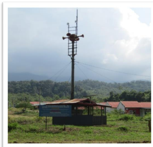
Sistem Peringatan Dini Banjir Sungai Malili
