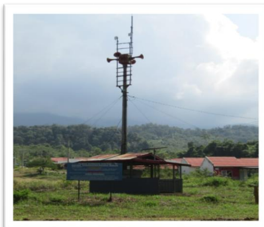
Sistem Peringatan Dini Banjir Sungai Malili
