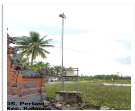
Sistem Peringatan Dini Banjir Sungai Kalaena
